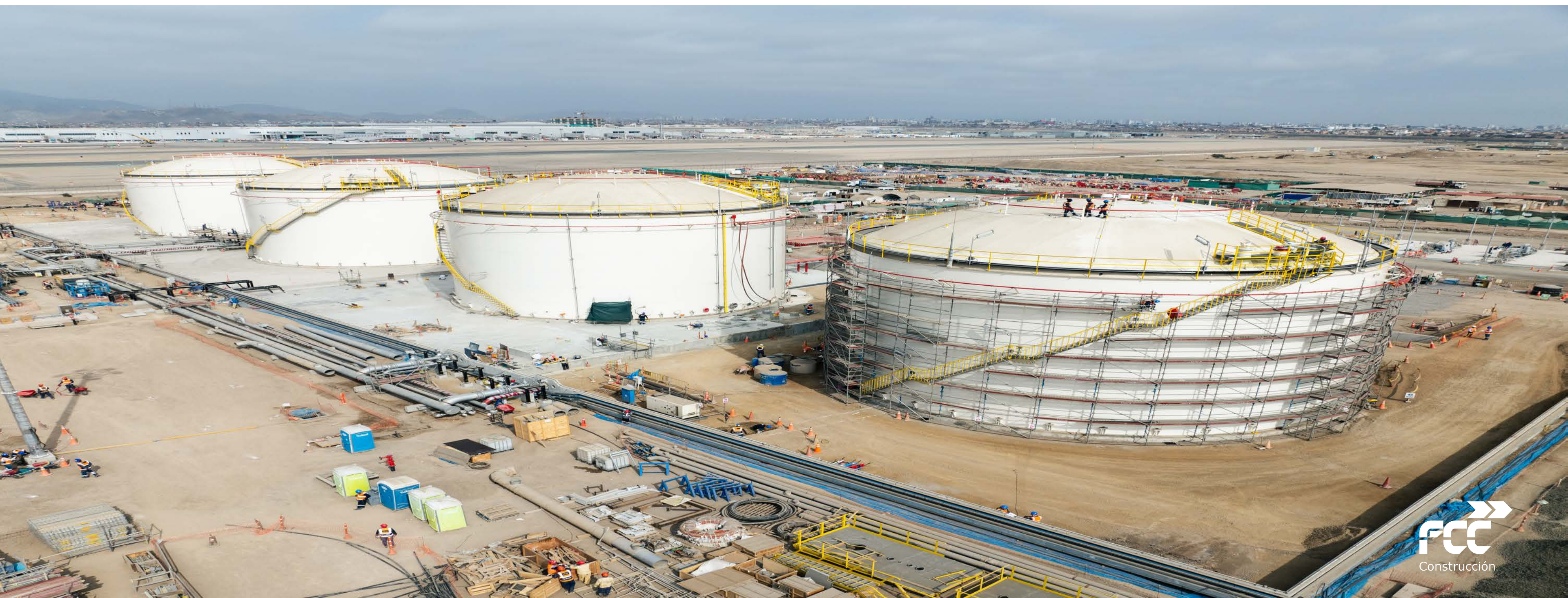
Central de armazenamento de combustível. Perú
